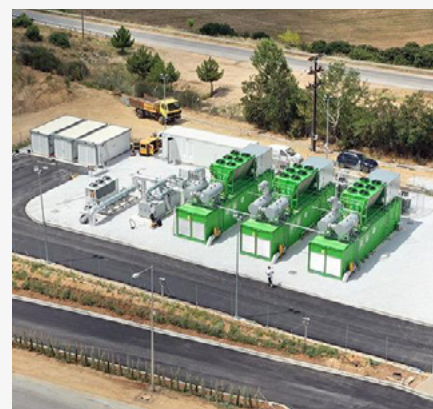
Μονάδα Βιοαερίου του Χ.Υ.Τ.Α Μαυροράχης που παράγει ηλεκτρική ενέργεια ικανή για περίπου 5.500 νοικοκυριά
