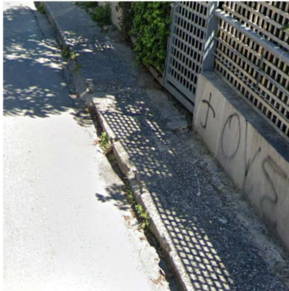
Εικόνα 21: Οδός Οινόης Κατάσταση Πεζοδρομίων
