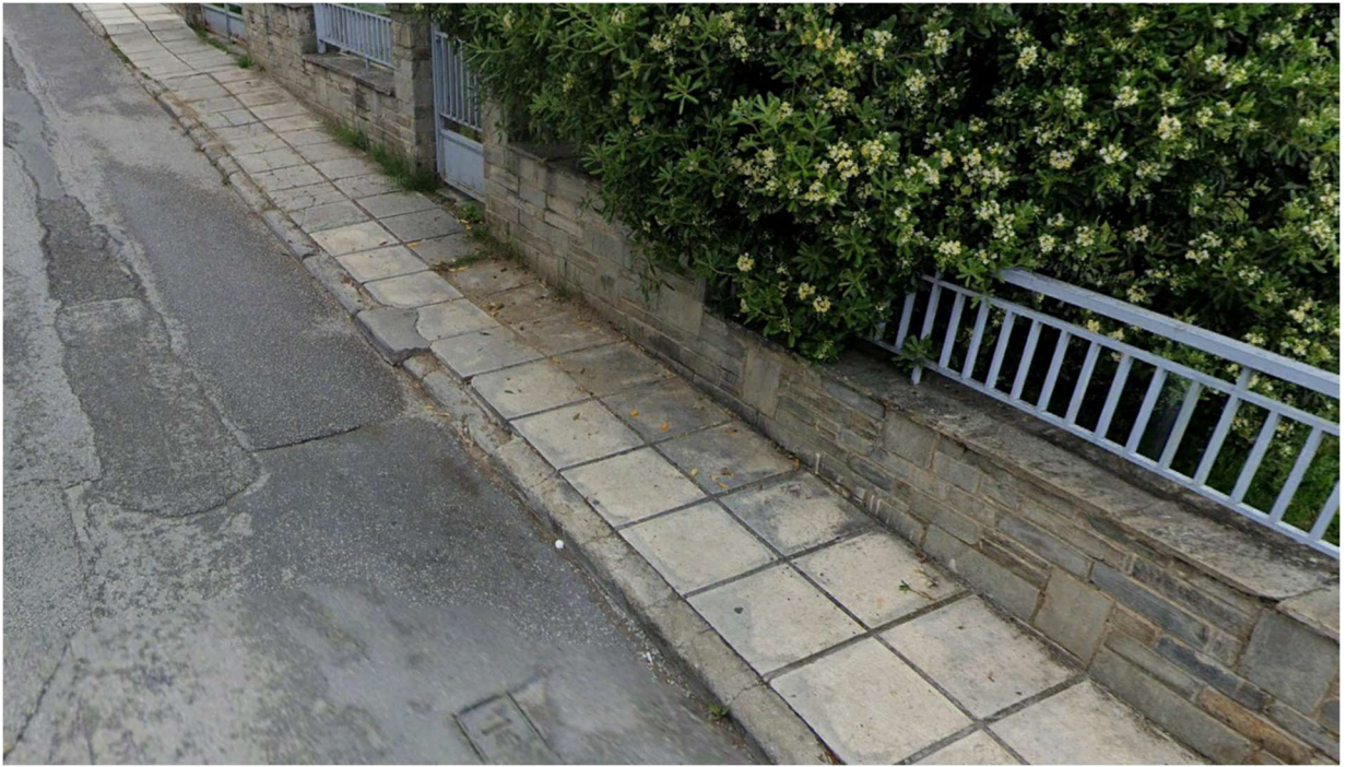
Εικόνα 38: Οδός Παπαδοπούλου 2 Κατάσταση Πεζοδρομίων
