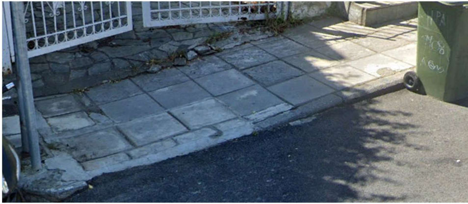
Εικόνα 62: : Οδός Αναλήψεως (από Παπαδοπούλου έως Κομνηνών) Κατάσταση Πεζοδρομίων
