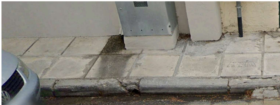
Εικόνα 82: Οδός Βενιζέλου (από Σοφούλη έως Κομνηνών) Κατάσταση Πεζοδρομίων
