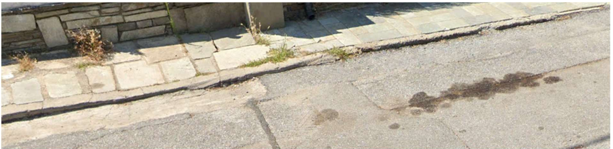
Εικόνα 53: Οδός Αναλήψεως (περιμετρικά του άλσους) Κατάσταση Πεζοδρομίων
